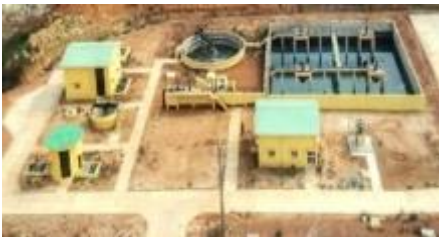
廃水処理プラント
